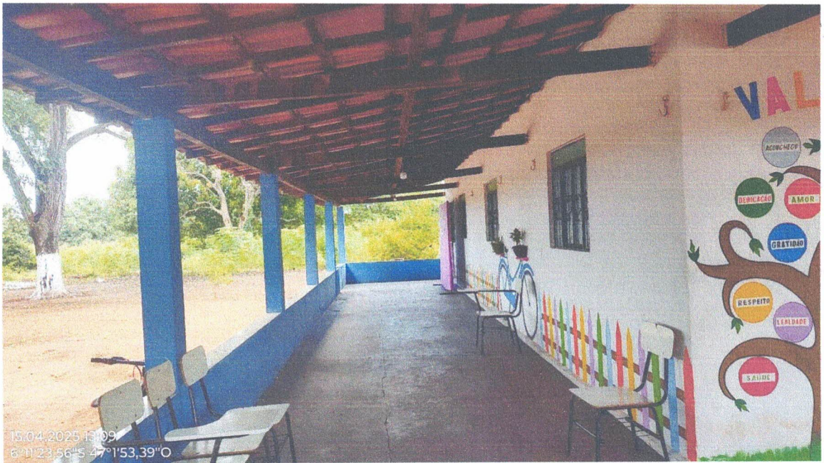
Figura 6 – Varanda Lat. Direita – Piso com fissuras.
