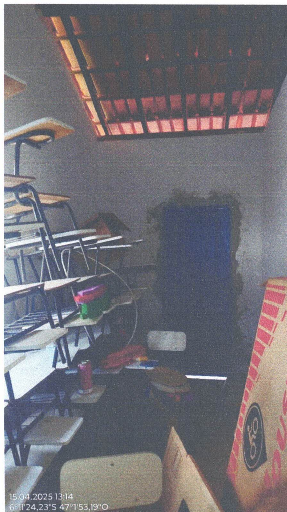
Figura 11 – Depósito / Instalação de porta sem acabamento – Fonte: elaboração própria
