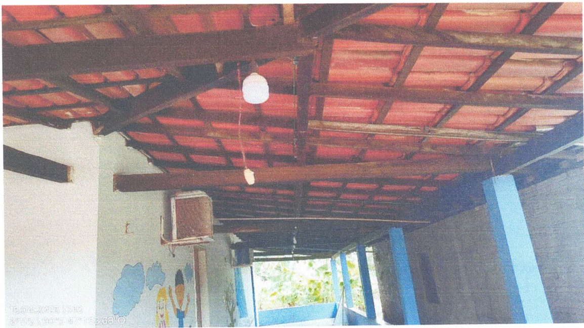
Figura 5 – Varanda Lat. Esquerda - Fiação exposta.
