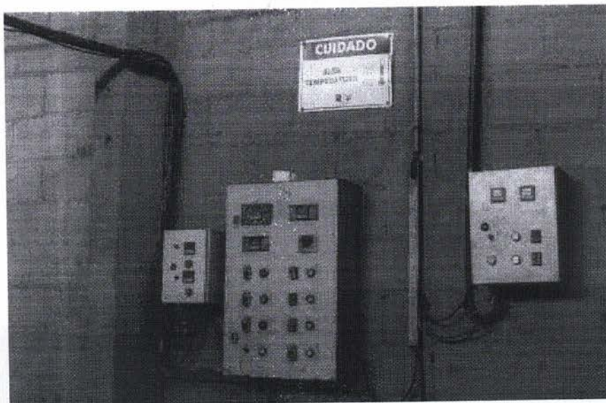
Imagem 10 – Painéis de controle.
