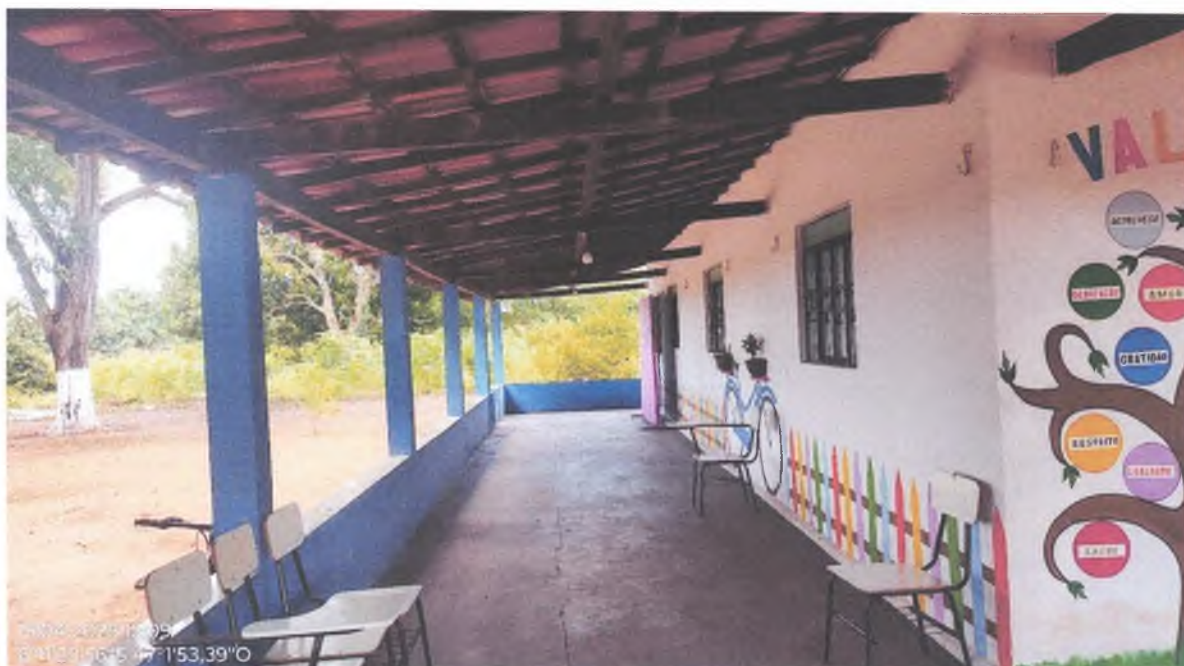
Figura 6 – Varanda Lat. Direita – Piso com fissuras.
