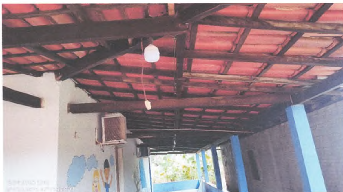
Figura 5 – Varanda Lat. Esquerda - Fiação exposta.
