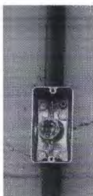
Foto nº 04: Caixa 01 de inspeção das descidas
